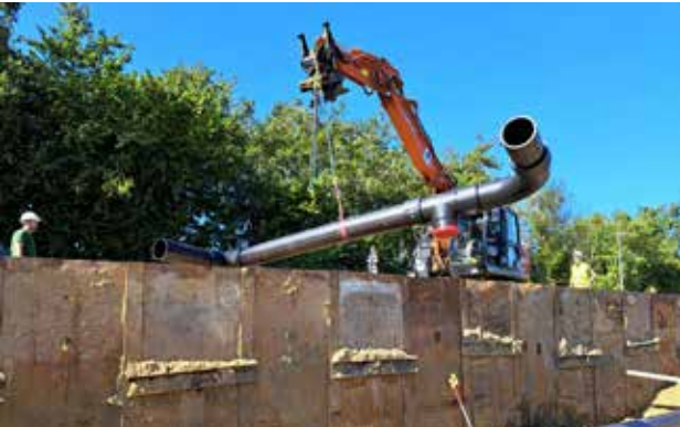
De HDPE-leidingen van Deschacht transporteren het te zuiveren water tussen de verschillende constructies.
